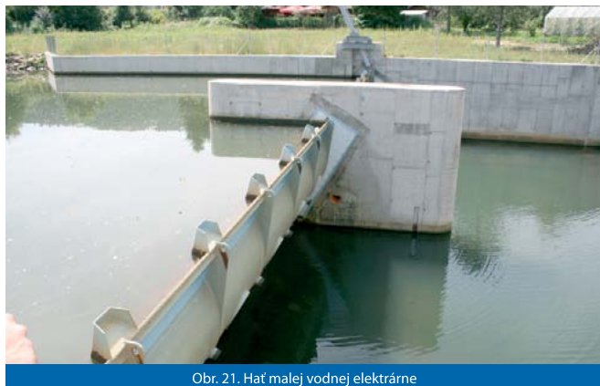
Obr. 21. Hať malej vodnej elektrárne
