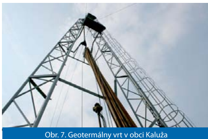
Obr. 7. Geotermálny vrt v obci Kaluža
